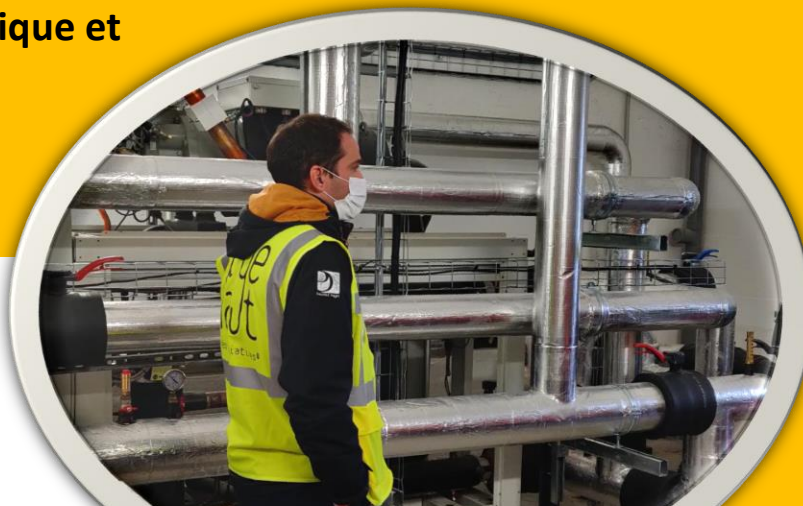
Présentation de l'installation de géothermie sur sondes aux élus du territoire par l'entreprise PAYET chargée de l'assistance à maîtrise d'ouvrage
